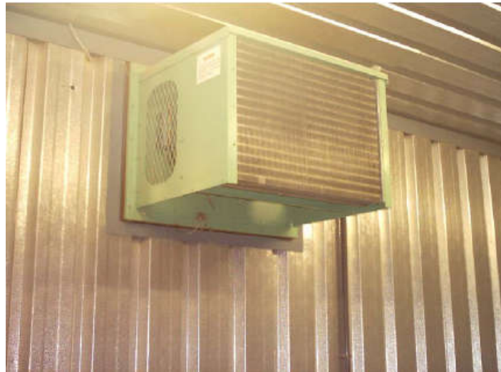
شكل (١٧) يوضح جهاز تكييف داخل غرفة حفظ البيض
