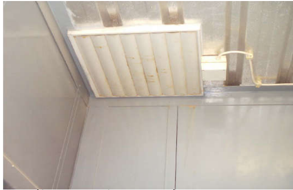
شكل (١٦) مروحة شفط الغاز في سقف الغرفة
