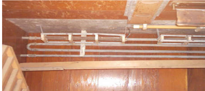
شكل (185) مصدر الحرارة داخل المفرخة
