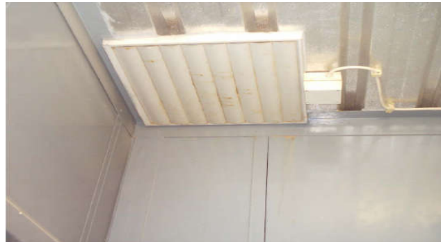
شكل (132) مروحة شفط الغاز في سقف الغرفة
