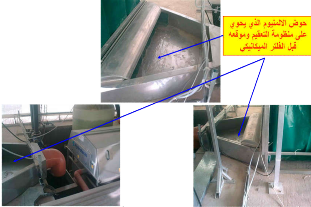
شكل يوضح منظومة تعقيم المياه باستخدام الأشعة فوق البنفسجية
